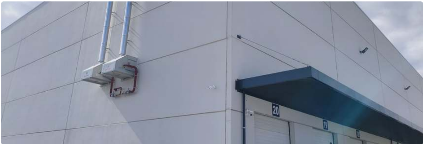
Generadores GIRAD en fachada · Vemare-Polaris, Pinto (Madrid), 2026. Se revisan desde fuera, sin parar la actividad de la nave.
