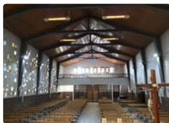
Iglesia · placas radiantes SUNRAD · 2019
