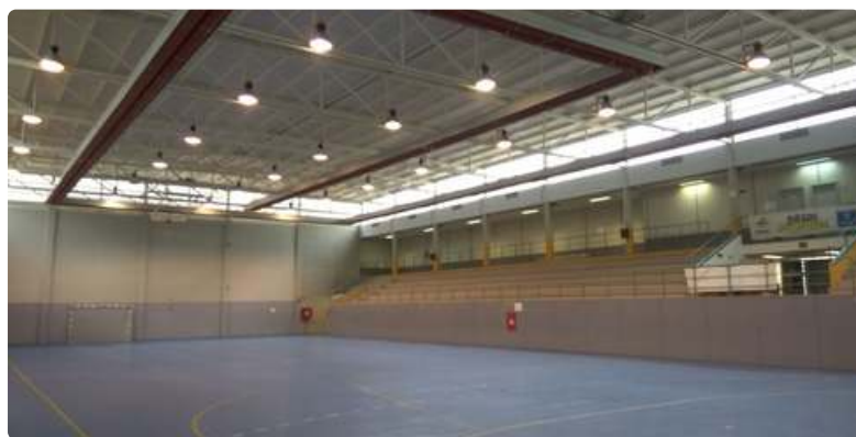
Polideportivo El Olivillo · conductos radiantes GIRAD en el perímetro de la pista
