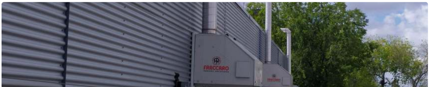
Generadores GIRAD en cubierta · Robert Bosch, Madrid, 2020. La combustión y la salida de humos quedan fuera de la nave.
