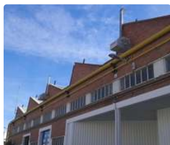
PSA Citroën · automoción · Madrid · 2015 · generadores en fachada
