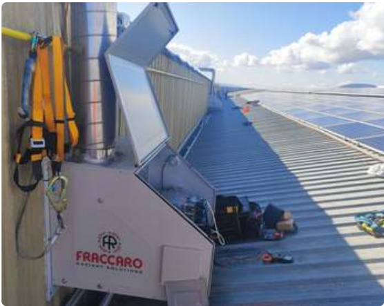
Generador GIRAD en cubierta · IMEFY, Los Yébenes (Toledo), junto a la planta fotovoltaica
